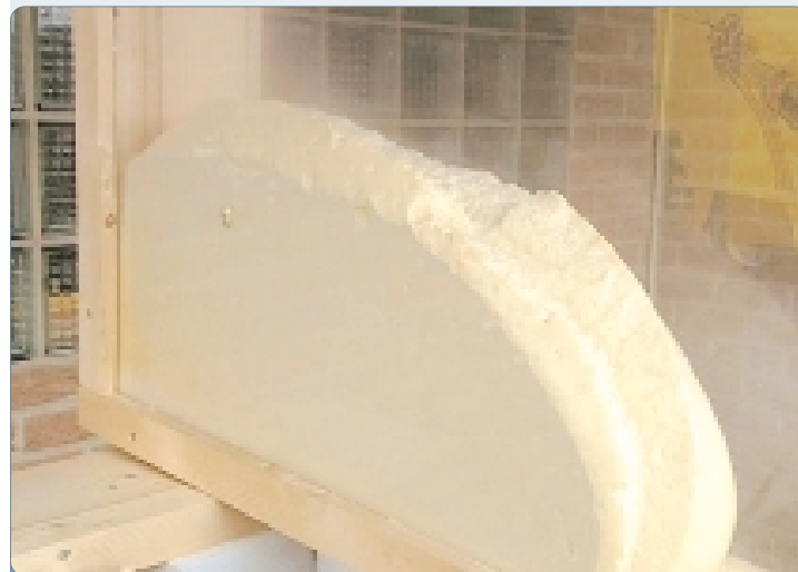
De 2 componenten beginnen te reageren en op te schuimen, zodat het zich in elke naad en kier van de spouwmuur nestelt
